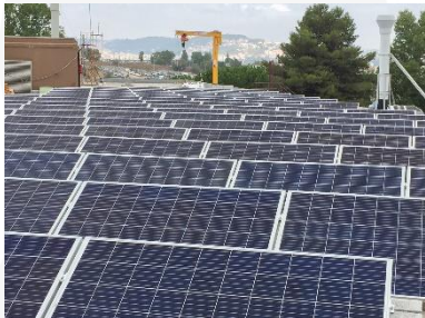
PV na cobertura de edifício LNEG/IAPMEI
